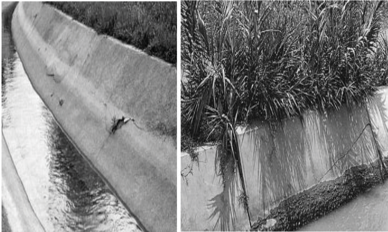
شکل ۸: تخریب پوشش بتنی کانال انتقال آب به دلیل رشد گیاهان
