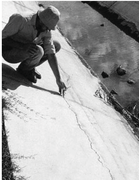
شکل ۵: به وجود آمدن ترک در پوشش بتنی به دلیل وجودنداشتن درز طولی
