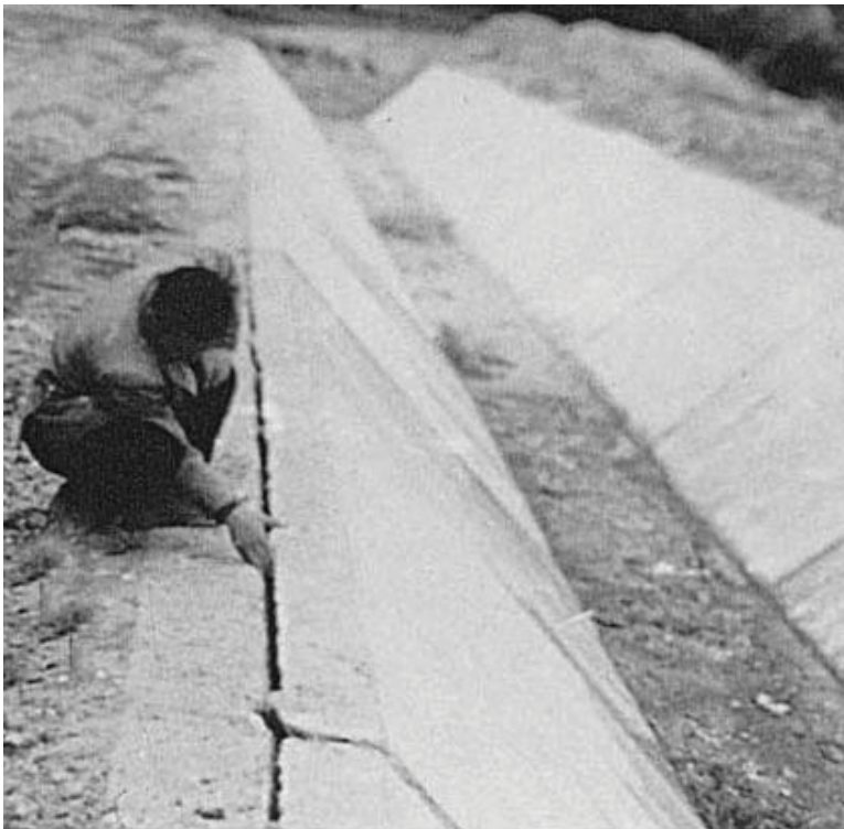
شکل ۴: به‌وجود آمدن ترک در پوشش بتنی به دلیل تورم خاک
